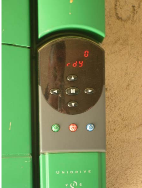
Regulador de frecuencia de electrobomba VTC
